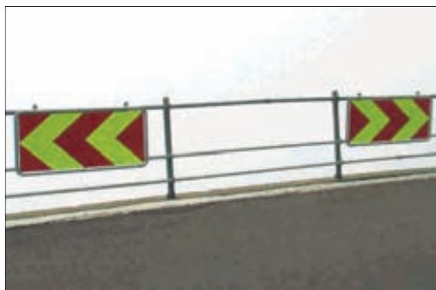
Beim Geländer in der Lini wurden zwei weitere Rohre eingezogen. Zusätzlich wurden auch Leitwinkel montiert.
